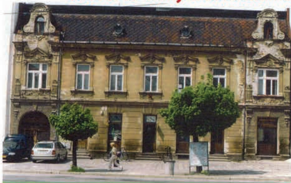
Obr. 1 Objekt před sanací vlhkého zdiva
