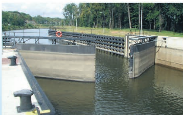
Lineární pohon – na vratech plavební komory
